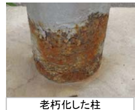
老朽化した柱
