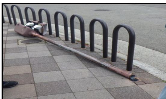
【腐食と人圧により倒壊した信号柱】
