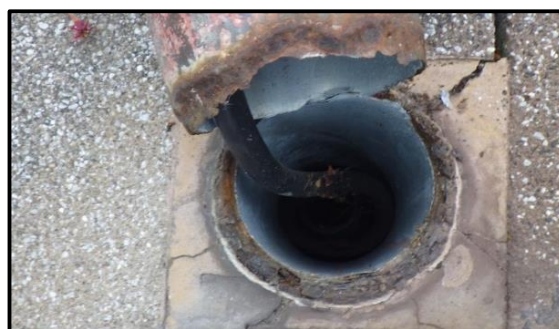
【倒壊した信号柱の地際部】
