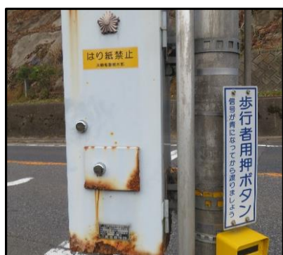
【腐食した信号制御機】
