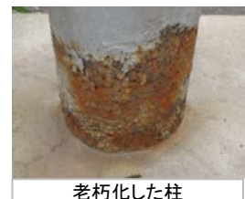
老朽化した柱
